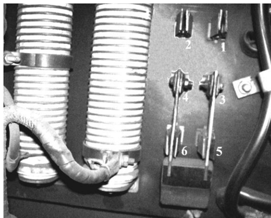
Рис. 145. Рубильник S1 усиленной зарядки аккумуляторной батареи блока A9
