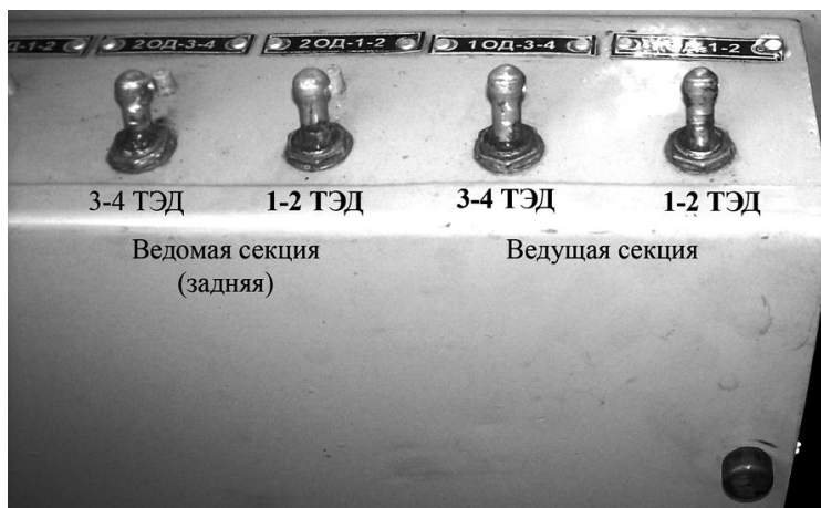
Рис. 313. Устройство 11. Блок тумблеров для дистанционного управления отключателями ТЭД - ПкД1 и ПкД2
