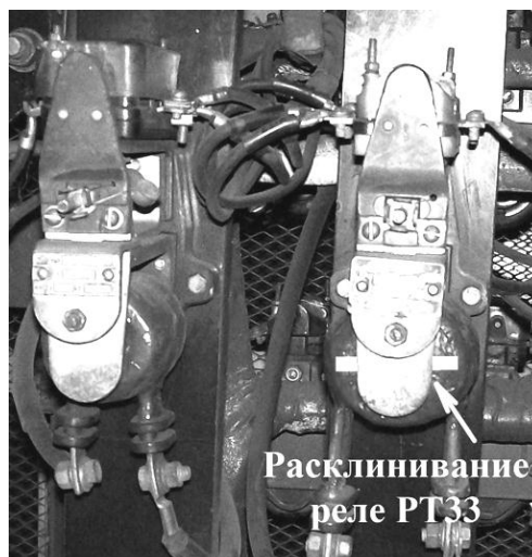
Рис. 264. Расклинивание якоря реле РТ33 в секции «А» и «Б»
